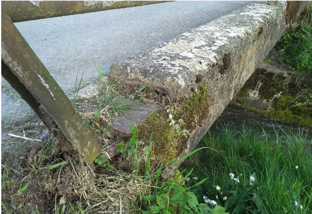
Abb. 6: Foto Schaden bei nordseitigem Randbord und Geländer
