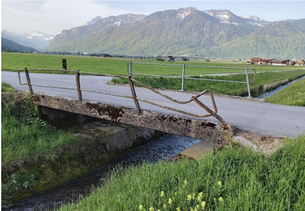
Abb. 7: Foto Schaden bei nordseitigem Geländer
