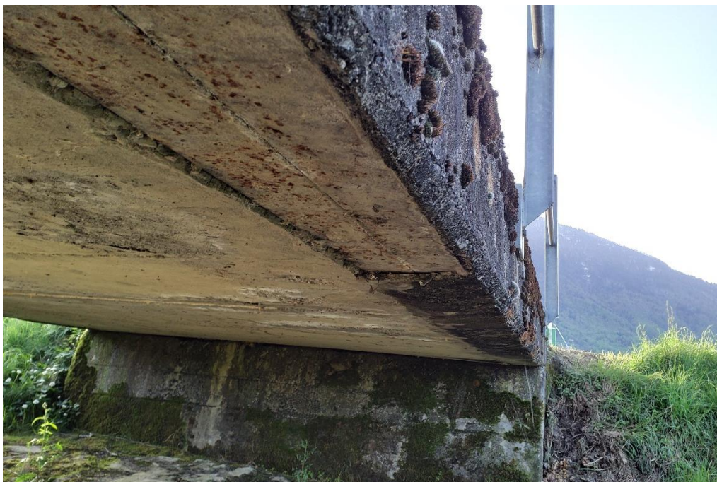
Abb. 8: Foto Schaden bei südseitigem Randbord Untersicht
