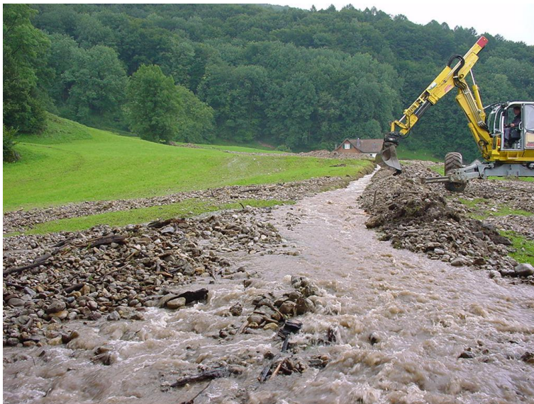
Abbildung 9: Sohlenräumung nach dem abklingenden Hochwasserereignis vom August 2005. Gerinne des Widöfeligrabens wurde während des Ereignisses ab dem Hangfuss vollständig mit Geschiebe verfüllt.
