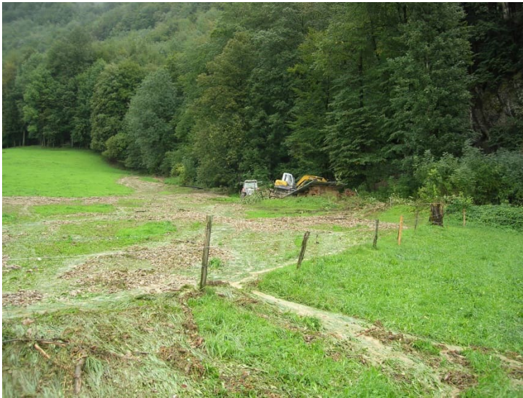
Abbildung 4: Ausbruch infolge Gerinneauflandung, Hochwasserereignis 2006 (vgl. Abbildung 6, roter Abschnitt).
