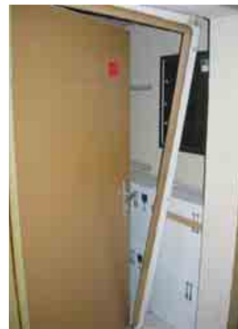
Aufgebrochene Türe der Zivilschutzanlage Hof.
