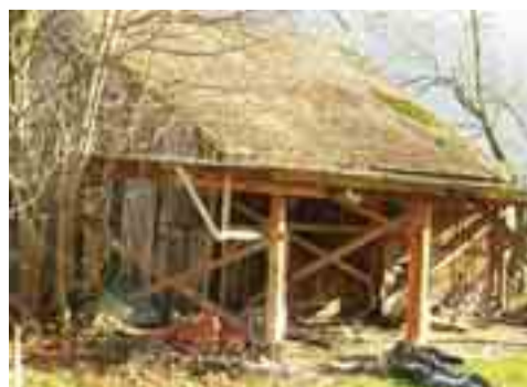
Mit der Erschliessung der Parzelle «Steine» muss gewartet werden, bis das Projekt zur Sanierung der Bäche vorliegt. Der Gemeinderat hat indessen den Abbruch der baufälligen Ställe beschlossen.
